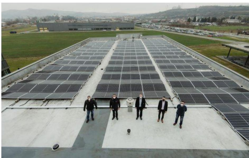
Figura 20. Sistem fotovoltaic instalat pe fabrica Bosch [25]
