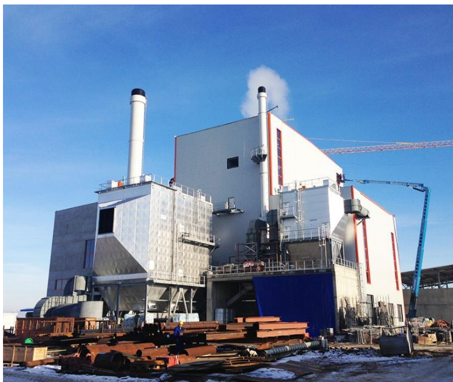
Figura 28. Centrală electrică pe biomasă [27]
