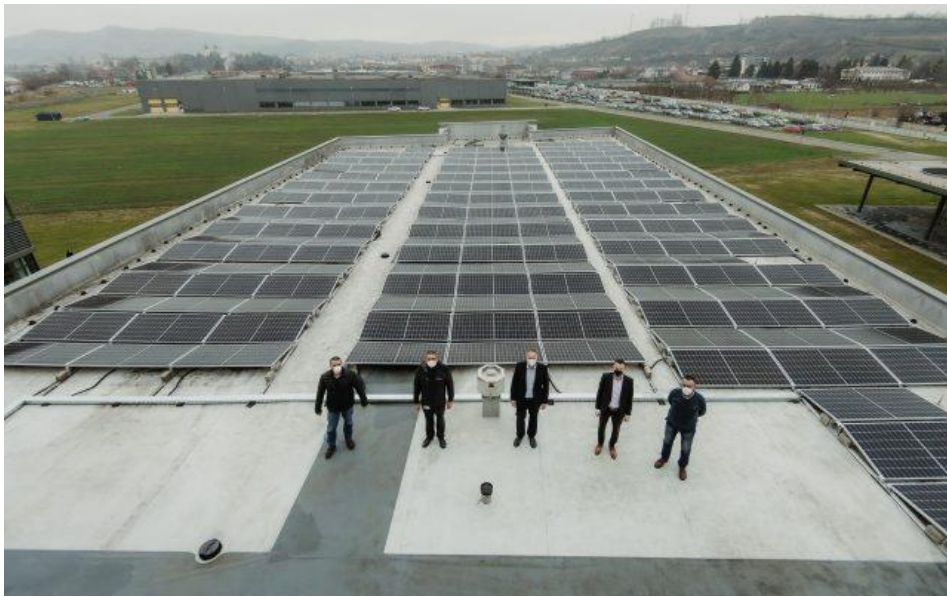
Şekil 20. Bosch fabrikasında kurulan fotovoltaik sistem [25]
